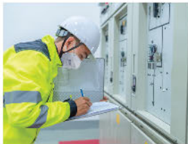
a) Vận hành hệ thống điện
