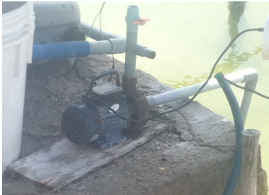
Máy bơm nước và ống dẫn nước vào
