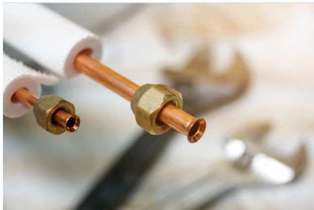
a) Ống dẫn ga ở điều hòa
