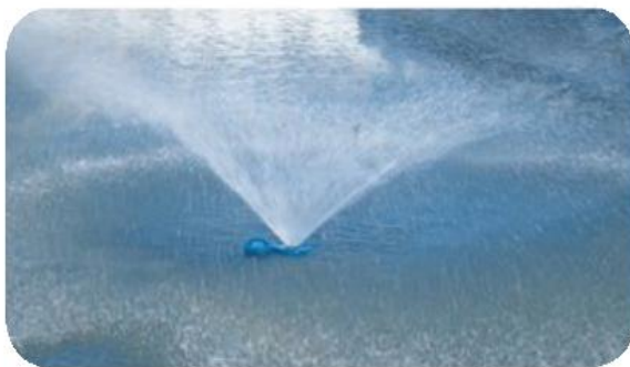
Hình 15.4. Máy phun mưa cho ao
